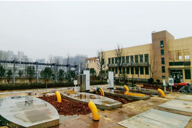
光谷金融港泵站
